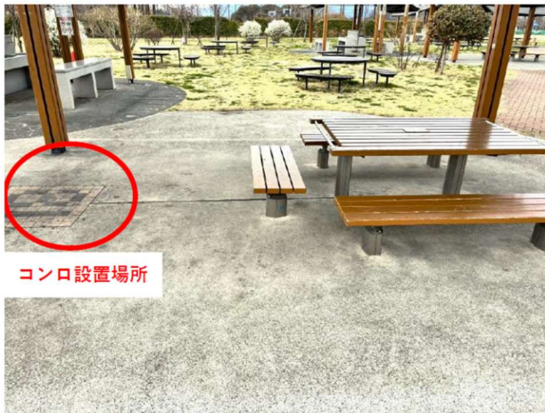
【屋根付きテーブルコンロ設置場所】
